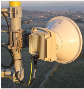
Figure 20 : outdoor unit (ODU) alimentée en FI par un câble coaxial et couplée directement à une antenne de 30 cm
