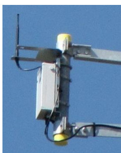
Figure 13 : exemple de base LoRa
