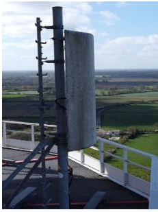
Figure 11 : antenne pour les réseaux INPT
