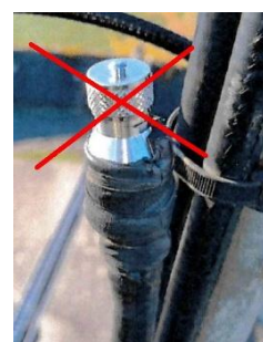
Figure 41 : exemple de câble terminé par un circuit ouvert au lieu d'une charge adaptée
