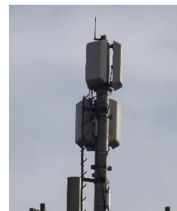
Figure 3 : antenne de diffusion TNT d'un émetteur de faible puissance
