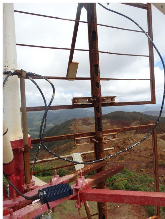
Figure 80 : exemple d'antenne FM corrodée pouvant contribuer à la production de produits d'intermodulation
