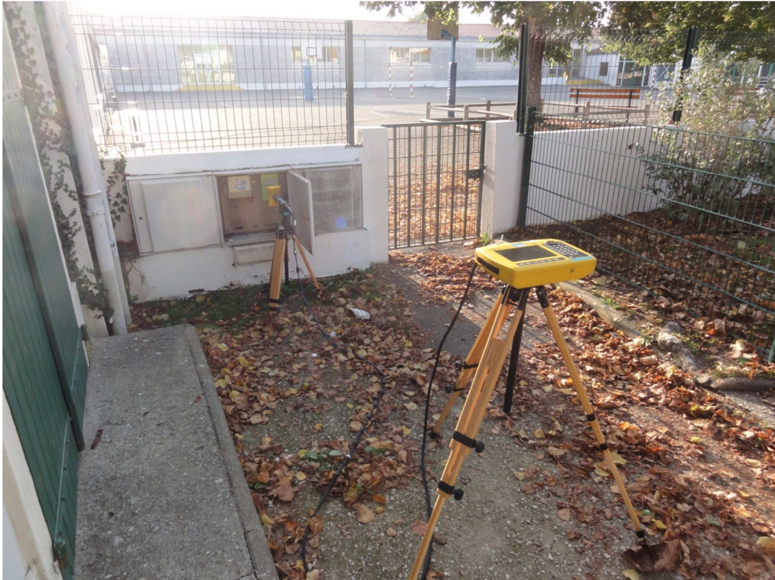
Mesure avec l'antenne électrique devant le compteur
