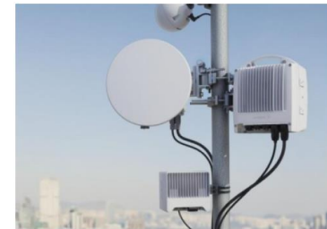
Antenne faisceaux hertziens pour le « backhaul »
