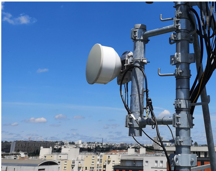
Figure 2 Photographie d'une antenne FH installé sur un toit d'immeuble
