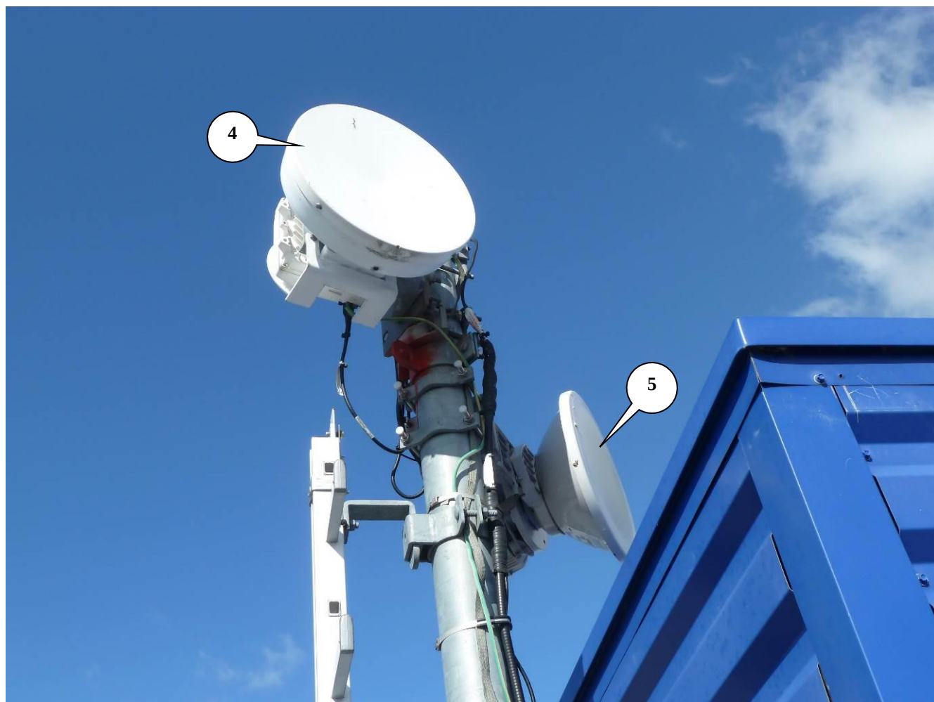
ANTENNES PARABOLIQUES SUR LA TERRASSE DU BATIMENT B29
