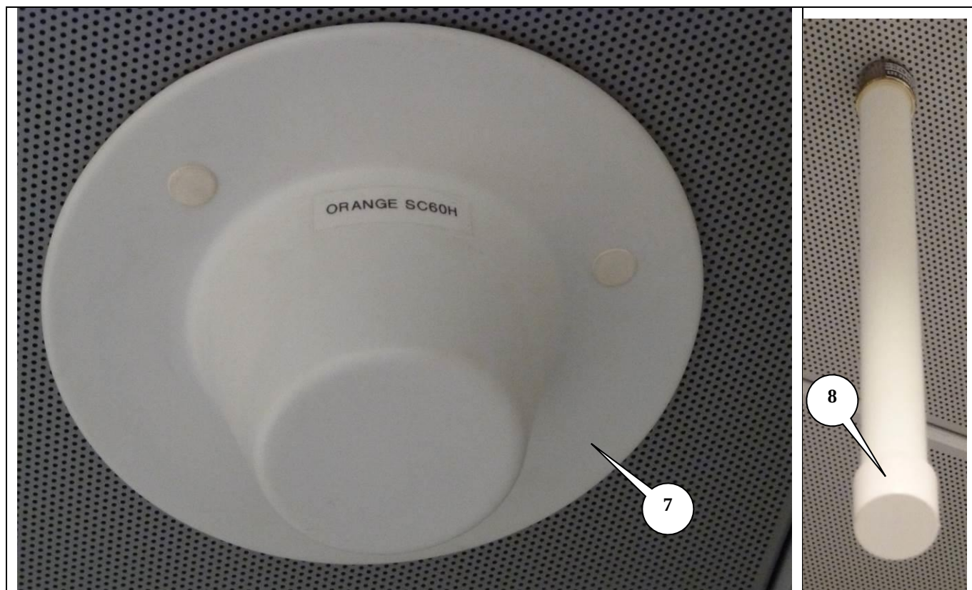
Antennes BTS indoor pour les opérateurs GSM
