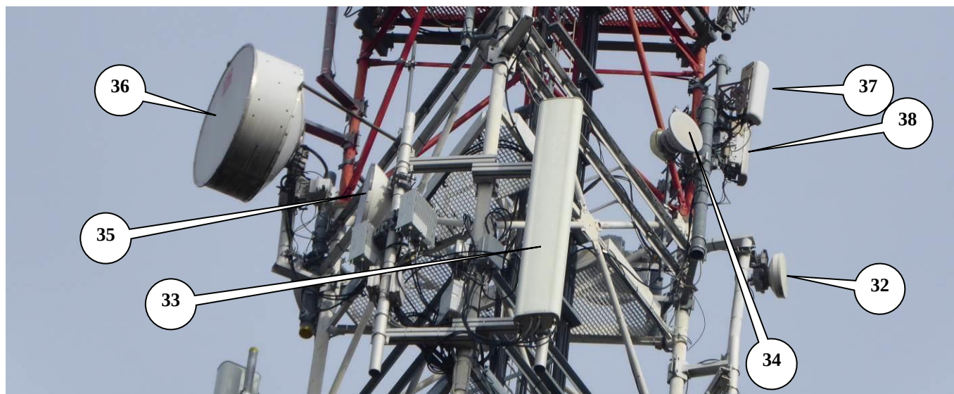
Vue depuis azimuth 190° du pylône (niveau 4) Les aériens en jaune sont vus par ailleurs
