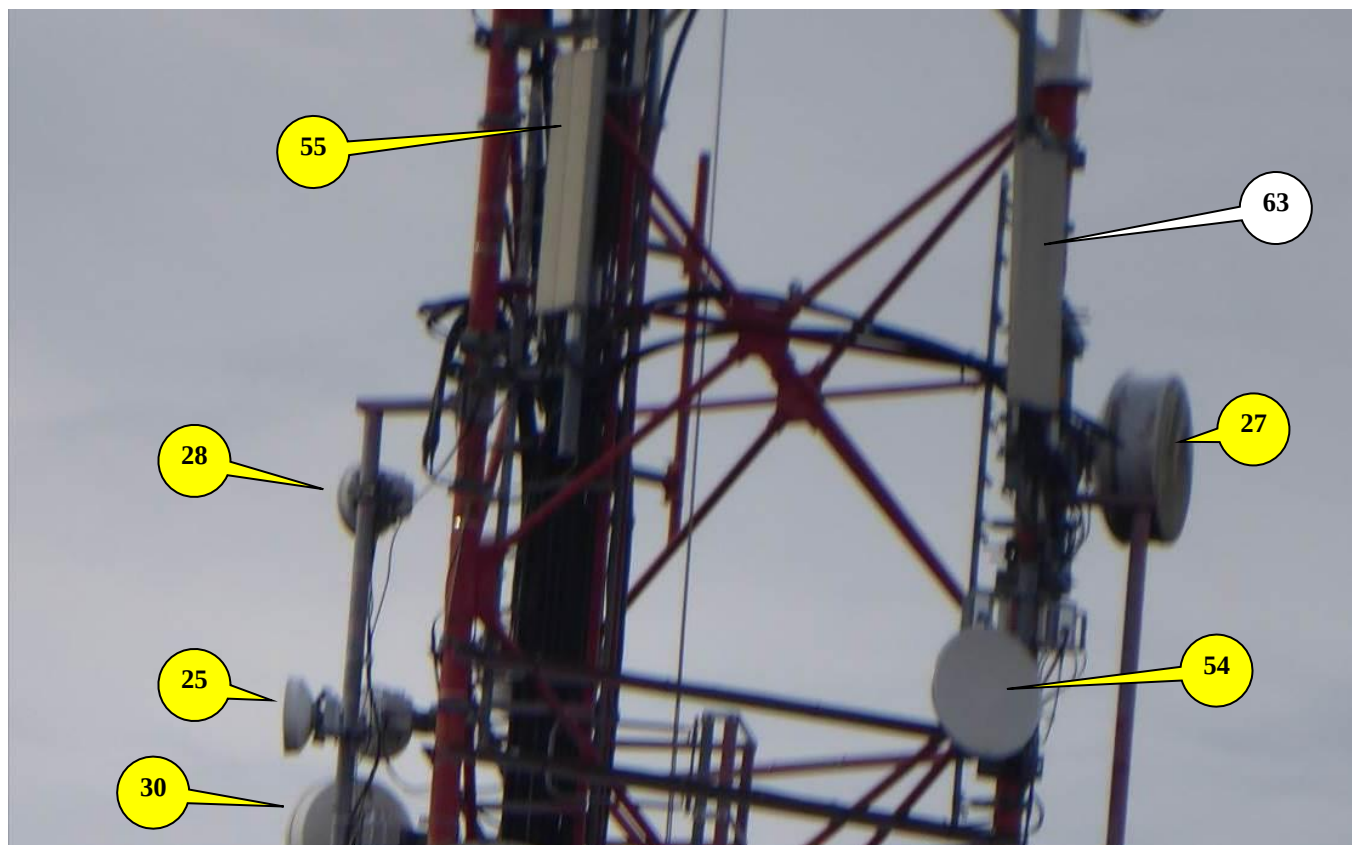
Vue depuis azimuth 30° du pylône (niveau3) Les aériens en jaune sont vus par ailleurs
