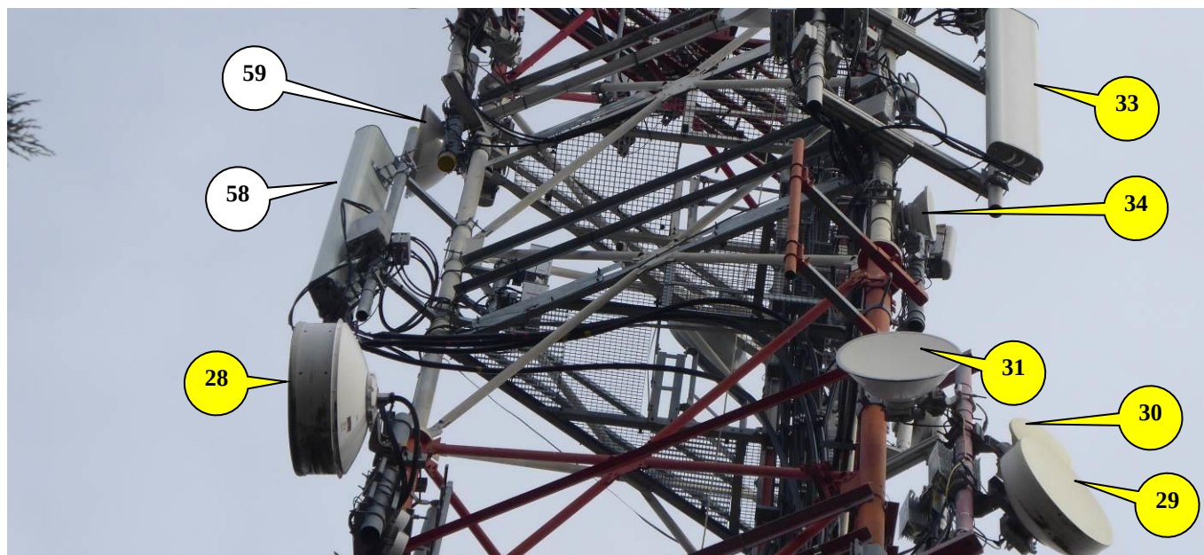
Vue depuis azimuth 225° du pylône (niveaux 3/4) Les aériens en jaune sont vus par ailleurs
