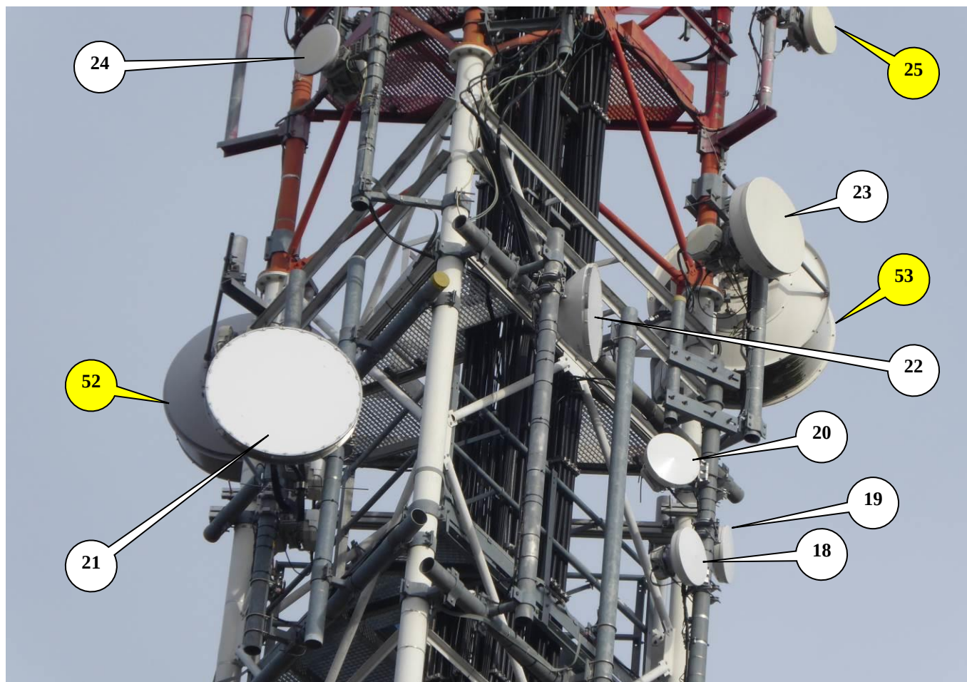
Vue depuis azimut 190° du pylône (niveau 2) Les aériens en jaune sont vus par ailleurs
