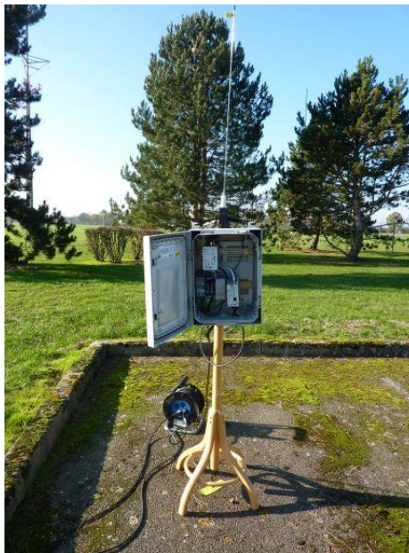
Figure 5 : installation du concentrateur SagemCom sur un trépied pour la réalisation des essais
